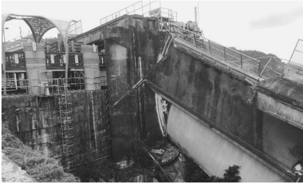
写真一八 被災部分である右岸部を背後から見る
