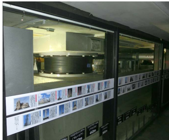
写真-2.2 名古屋大学における積層ゴム型免震装置
