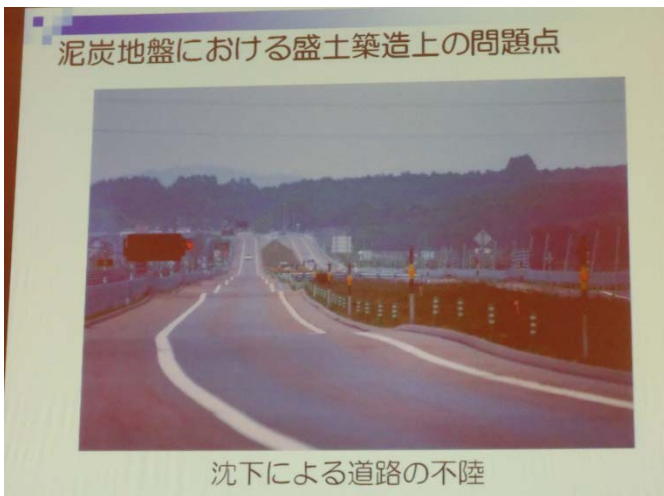
p-6 泥炭地盤における道路盛土の不同沈下
