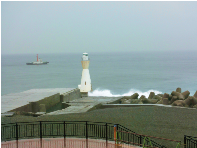
写真-1.10 防波堤工事 (波浪で破損した旧のケーソン外側に新ケーソン施工)
