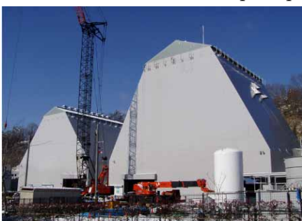
p-1 防音ハウス
